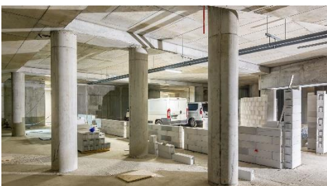
Slika 12: Okrogli stebri izvedeni s SRS krožnim jeklenim opažem. (slika: PERI oplate i skele, d. o. o.)
