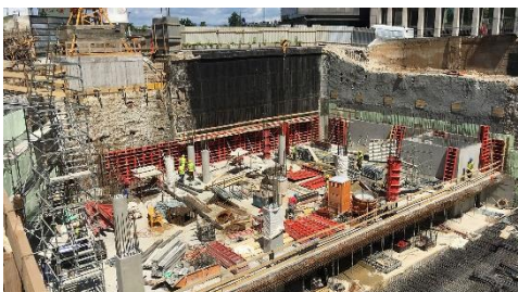
Slika 1: Stopnišče PERI UP Flex omogoča vertikalno komunikacijo od najnižje podzemne etaže pa vse do 22. etaže.
