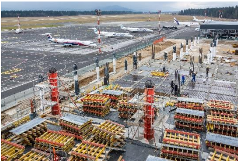
Slika 6: Opažni elementi VARIO GT24 so v skladu z zahtevami za vidne betone sestavljeni v delavnici PERI v Velikem Trgovišču in dostavljeni na gradbišče. (slika: PERI oplate i skele, d. o. o.)
