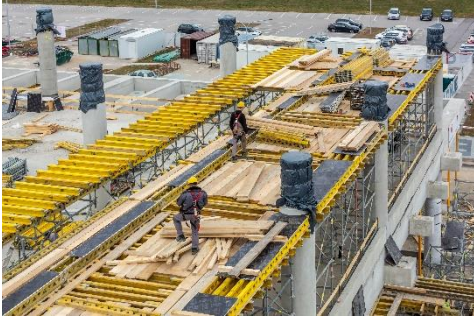
Slika 5: Fleksibilen MULTIFLEX stropni opaž s primarnimi GT24 in sekundarnimi VT20 nosilci in opažnimi ploščami FinPly. (slika: PERI oplate i skele, d. o. o.)
