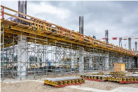
Slika 14: PERI UP Flex podporni stolpi za visoko podpiranje stropnih nosilcev izvedenih z VARIO GT24 opažnimi elementi. (slika: PERI oplate i skele, d. o. o.)
