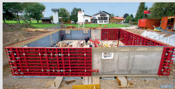
Kratko vrijeme gradnje uz manje radnog osoblja. Podrum dvojnog stambenog objekta, Rosenheim
