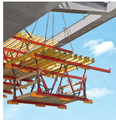
Kod ovog mosta s kolnom konstrukcijom nosači GT 24 izvode opterećenja u predmontirane jedinice sastavljene od SRU čeličnih profila i SLS vretena za teška opterećenja. Visoka nosivost dopušta velike raspone uz minimalno savijanje.
