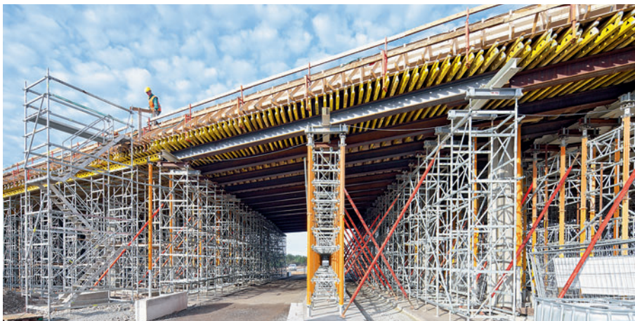
Kod ove konstrukcije mosta nosači oplate GT 24 nose opterećenja od betoniranja u donju konstrukciju projektiranu prema specifičnostima projekta.
